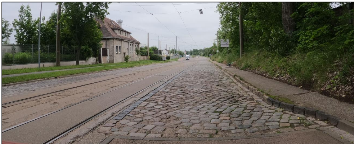
Abb. 4 Oberflächendefizite im Straßennetz mit Verkehrsaufkommen > 3 Mio. Kfz/a
