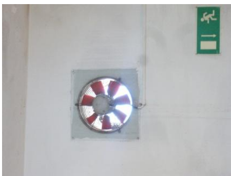
Foto A14, Lüfter Turnhalle, Planungsbüro Wahlbuhl 2012
